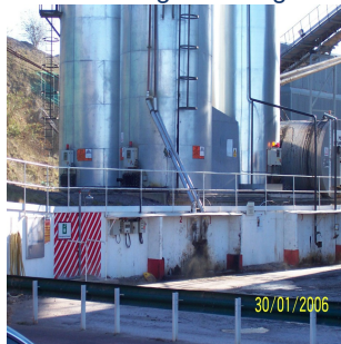
Bitumen discharge area
